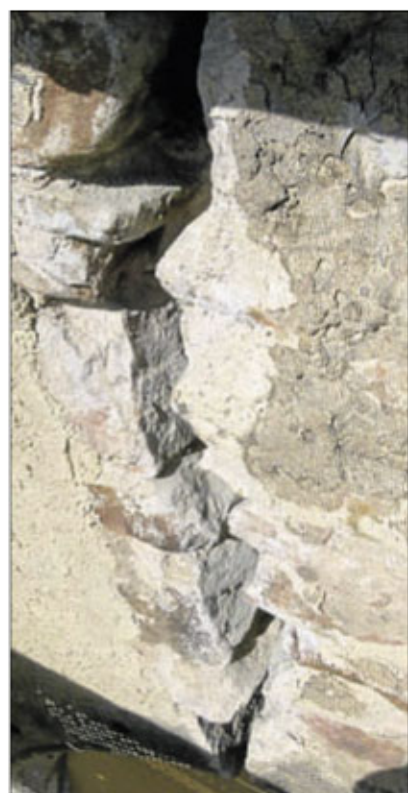
Einer der zahlreichen senkrechten Risse. Dieser an der Ostseite ist der Gravierendste.
