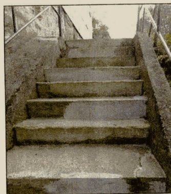
Kirchgässchen: Die kaputten Stufen sind notdürftig ausgebessert.
