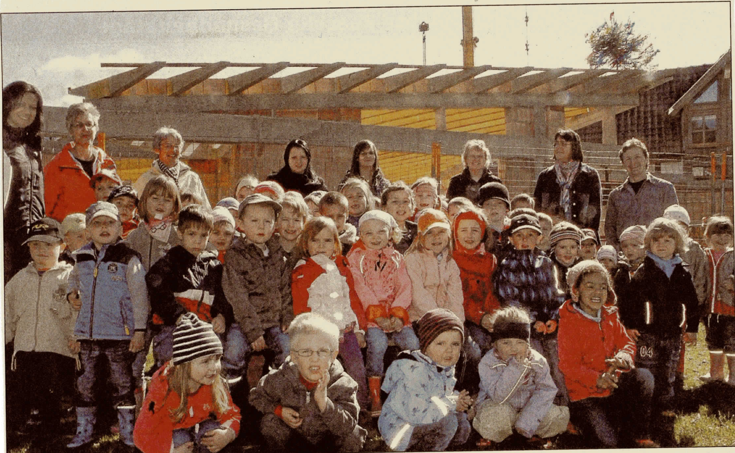
Freuen sich auf die neue Gruppe: Die Kinder und Mitarbeiterinnen des Evangelischen Kindergartens Altmorschen ziehen demnächst in den neuen Gebädetrakt ein. Gestern war Richtfest. Foto: M. Berger
