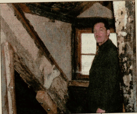
Er knirscht im Gebälk: Enorme Bauschäden zeigen sich unter dem Dach des Herrenhauses in Altmorschen. Unser Bild entstand 2004. Inzwischen ist Bürgermeister Herbert Wohlgemuth mit seiner Verwaltung ausgezogen.
